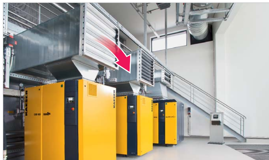
Fig. 3 : Station d'air comprimé avec une ventilation thermostatée
