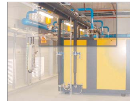
Fig. 3b : Raccordement du compresseur avec des compensateurs axiaux
